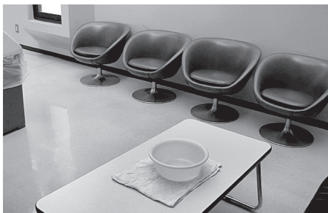
雨漏りしていた文化会館小ホール
